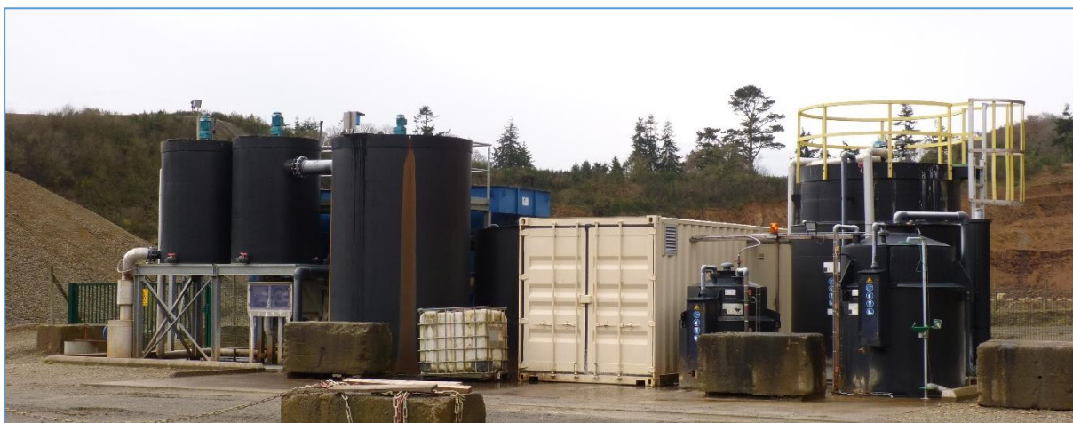
Fig. 61 : Vue sur l'installation de traitement des eaux acides
