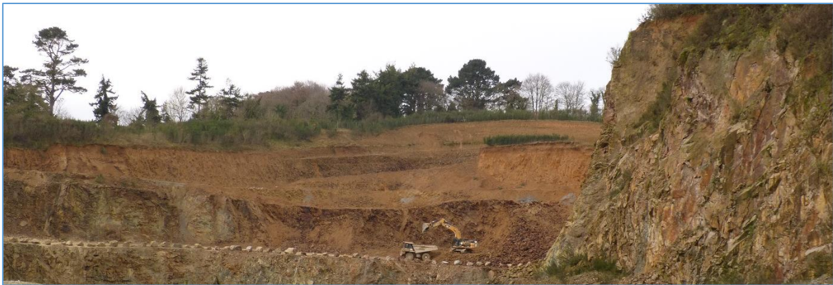
Fig. 45 : Vue n°8 : Reprise des matériaux bruts en pied de front à la pelle
