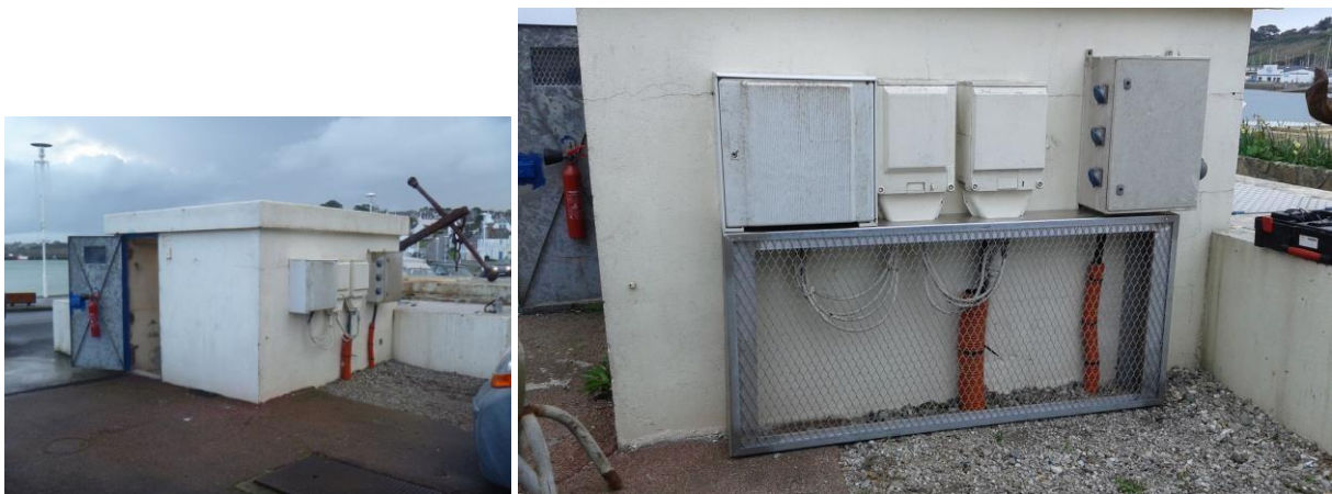
Figure 11 : vue des armoires de livraison, avant et après sécurisation par la commune
