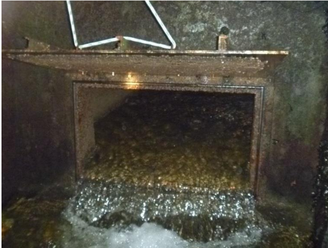
Figure 4 : Vue de près du clapet
