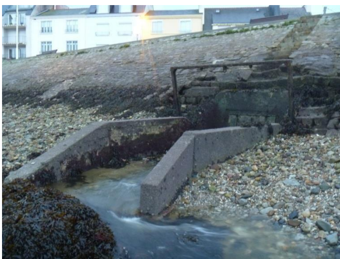
Figure 2 : Partie aval du clapet, avec longrines de conduite du flux, portance pour accrocher les cordes de levage du clapet
