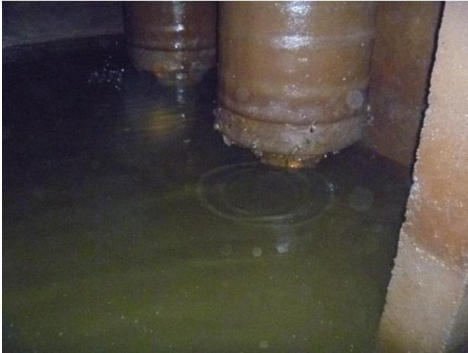
Figure 10 : vue des extrémités des pompes dans la bache de pompage
