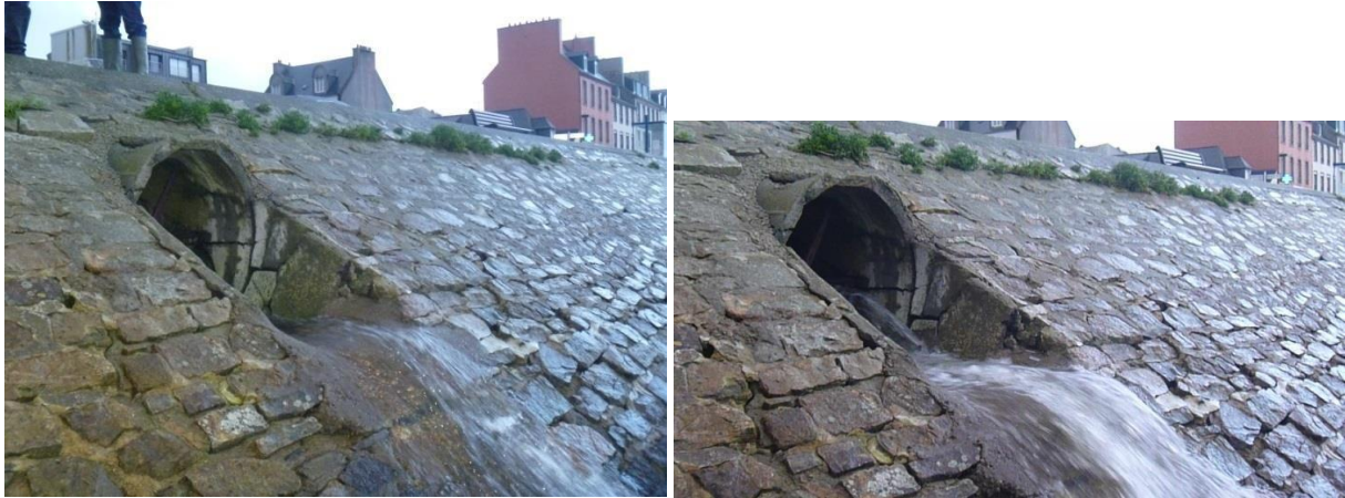
Figure 8 : Vue du by-pass avant pompage (à gauche), et pendant pompage (à droite)
