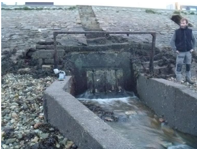
Figure 3 : Vue du clapet en fonctionnement EVACUATION des eaux pluviales
