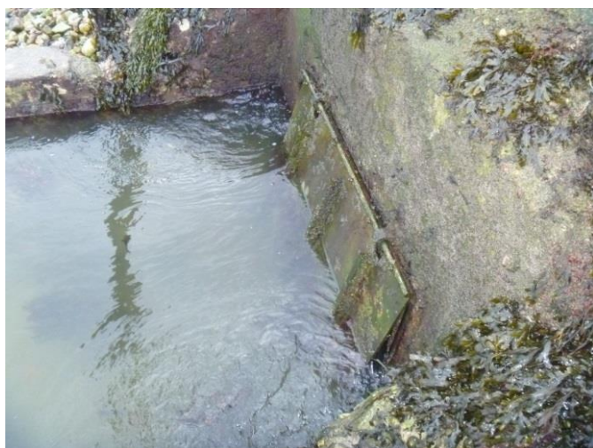
Figure 7 : vue du clapet en situation semi-fermé à marée montante
