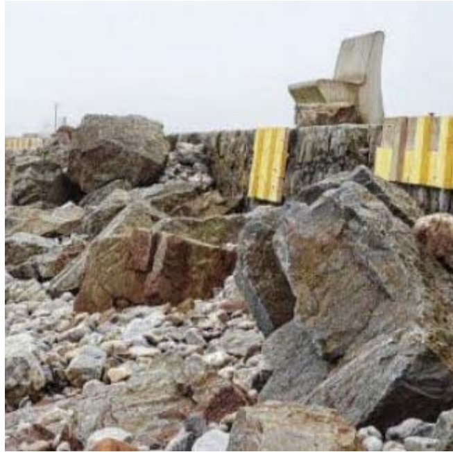
Dommages sur mur de protection du Sillon (les coffrages en jaune correspondent à des travaux de réparation) et vue sur les enrochements en pied d'ouvrage (photo Le Télégramme, 21 février 2014)
