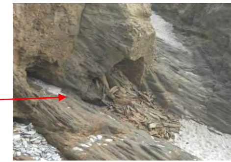
Sous-cavage avec éboulement de matériaux
