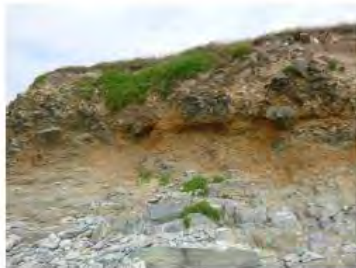
micro-falaise sous-cavée par érosion marine dans l'escarpement côtier au droit de la parcelle 490
