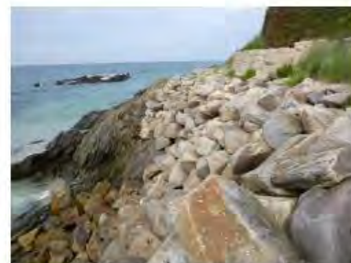
Désorganisation d'encrochements à la base de l'ouvrage consécutive aux chocs des vagues développées lors des tempêtes de 2014 au droit de la parcelle 103
