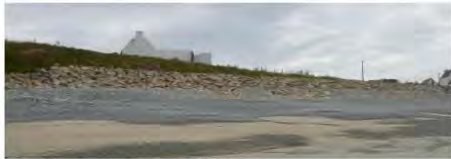
Versant protégé par un perré en enrochements d'une hauteur apparente de ~3m au droit des parcelles 157 et 142
