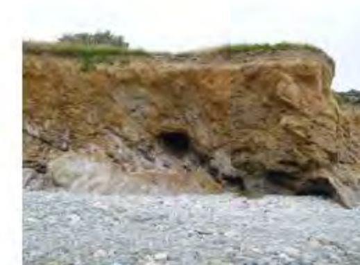
développement d'une grotte de 1.3m de haut, 2.3m de profondeur et 1.5m de large sur la moitié basse de l'escarpement côtier par érosion marine au droit de la parcelle 665
