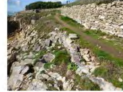
Destruction partielle de murets de soutènement en pierres sèches de la sente par vieillissement ou consécutive aux chocs des vagues développées lors des tempêtes de 2014 au droit de la parcelle 84
