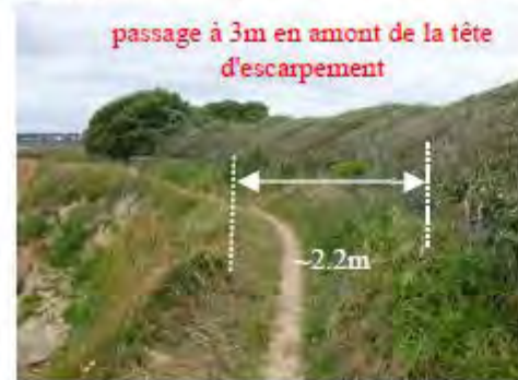
Sentier au droit de la parcelle 495 à délocaliser en amont du muret
