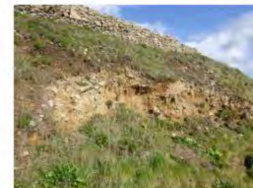
escarpement de tête d'un glissement au sein du manteau de matériaux meubles au droit de la parcelle 95
