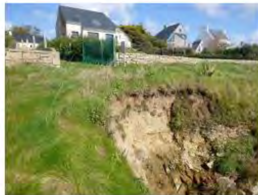
glissement dans des colluvions au droit d'un secteur faillé présentant d'importantes circulations d'eaux à la limites des parcelles 98 et 99
