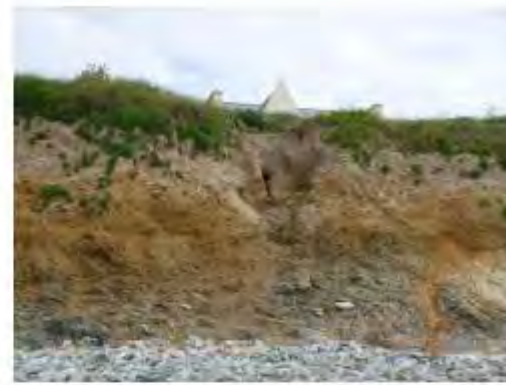
érosion par ruissellement au droit d'un exutoire de la parcelle 495
