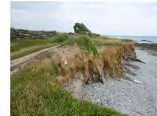
érosion par ruissellement des matériaux argilo-sableux de plage ancienne affleurant en tête d'escarpement côtier sous la parcelle 665
