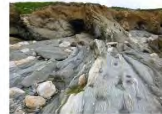
développement d'une grotte de 3m de haut, 4.3m de profondeur et 2.4m de large à la base de l'escarpement côtier par érosion marine au droit de la parcelle 665
