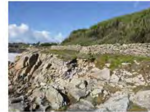
Destruction partielle de murets de soutènement en pierres sèches de la sente consécutive aux chocs des vagues développées lors des tempêtes de 2014 au droit de la parcelle 85
