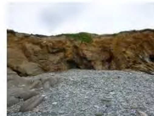
érosion marine sous-cavant l'escarpement sur 1.7m de haut et 1.1 m de profondeur et déstabilisant la partie supérieure de l'escarpement au droit de la parcelle 665
