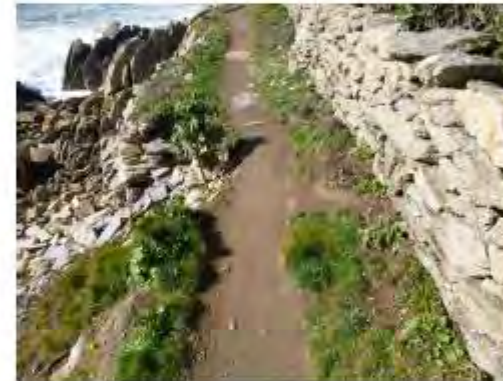
réduction de l'assiette de la sente par lessivage des matériaux meubles suite à la rupture partielle du muret au droit de la parcelle 85
