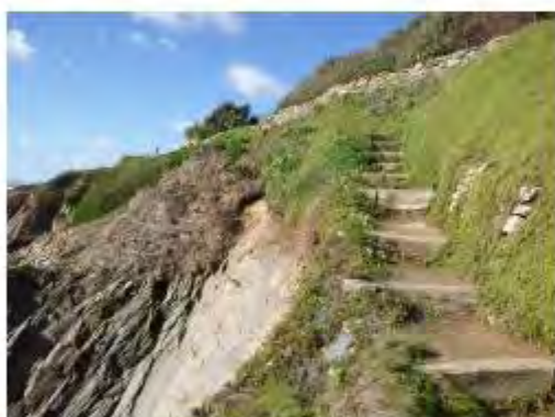
glissement de dalles schisteuses sous la parcelle 102
