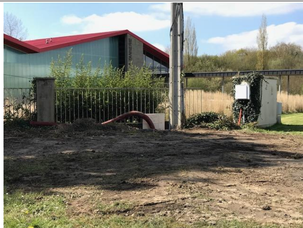
Nouveau coffret électrique posé par ENEDIS en entrée de site
