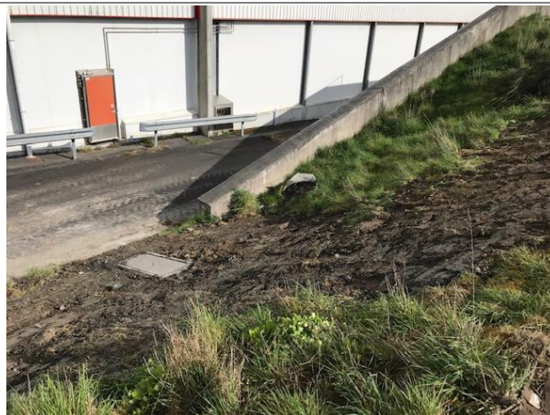
Nouvelle chambre pour raccordement électrique des bâtiments conservés posée par la STEPP
